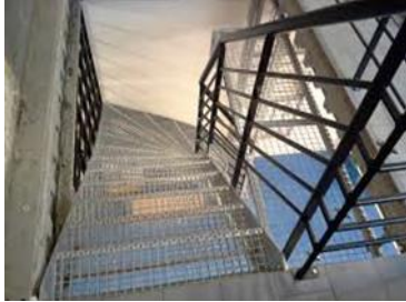
Obr. 23 Nevhodné řešení schodiště (příkré, tmavé).
