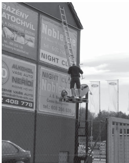
Při nefešení těchto prací ve výšce s ohledem na požadavky bezpečnosti práce to v praxi dopadá tak, jako je to zachyceno na následující fotografii.
