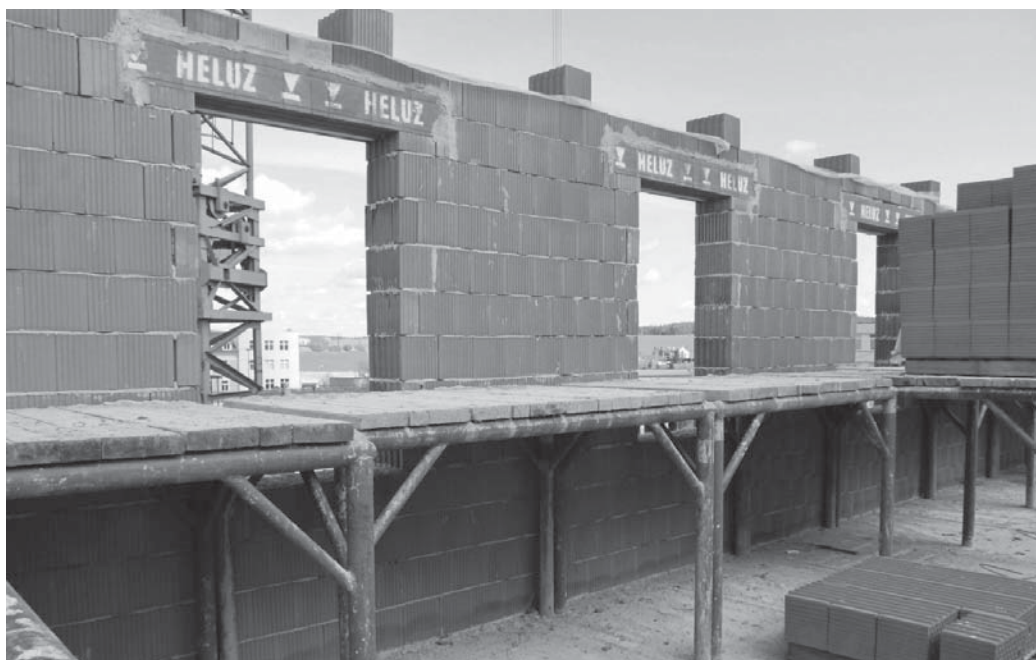
Ukázka špatné koordinace opatření k zajištění bezpečnosti práce při zdění
